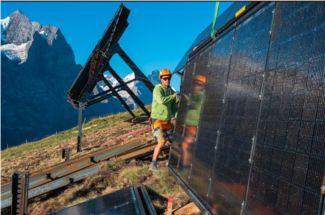
Auf dem Schattenhalber Boden von Grindelfeld hat die BKW bereits eine Testanlage gebaut – das definitive Projekt würde 640 solcher Tische umfassen. Foto: PD, BKW
